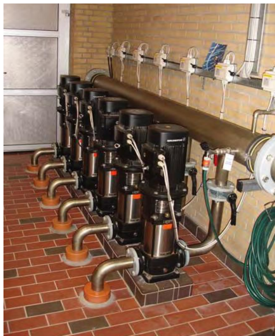
Foto af rentvandspumper
