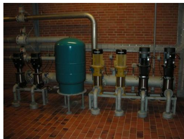
Udpumpningsanlæg og membranhydrofor
