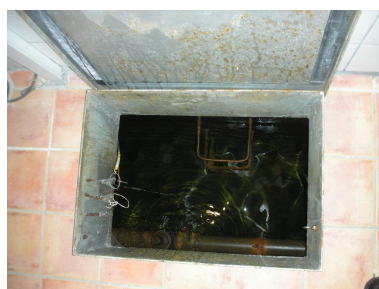
Nedkig i rentvandstank 1
