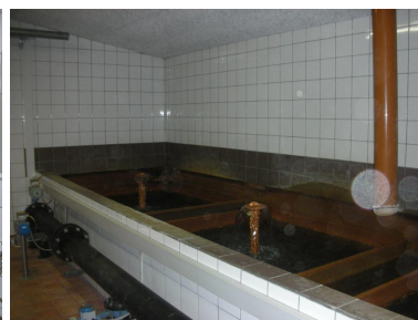
Filteranlæg med overløbsrør fra iltningstårn
