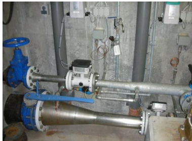
2 udgange m/ elektroniske målere
