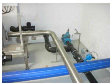
Indgang råvand fra vandværk
