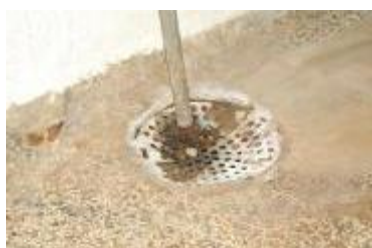
Afløb i gulv ????
