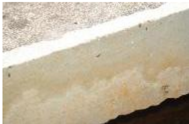
Biller under låget på iltningstårn
