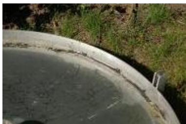
Defekt pakning - B Vest
