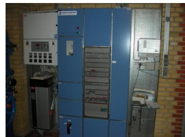
Frekvensstyret udpumpning El-tavle, alarm
