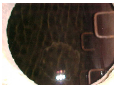
Et kig ned i den nye rentvandsbeholder
