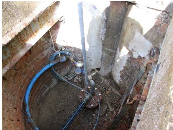
DGU 59.182 / INIT JLE / DATO 25.08.2014 . Fototema // Teknisk indretning/ Pejlepunkt
